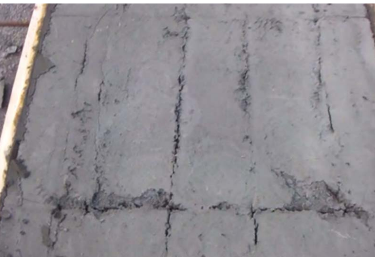
Fig. 6b: Evidencia adicional de valles visible desde el lado cimbrado.
