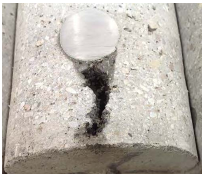
Fig. 2: El principal defecto de este núcleo es evidencia de un flujo inadecuado durante la colocación.
