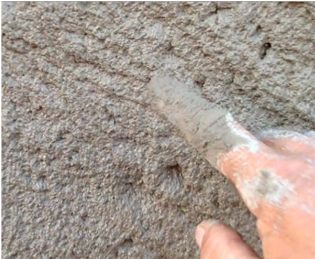
Fig. 9: Los materiales recién aplicados con pocos agregados visibles en la superficie son el indicador visual de un revenimiento bien elegido.
