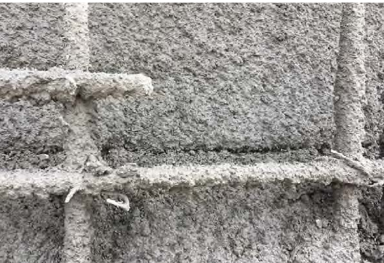
Fig. 6a: El valle que ocurre dentro del área de sombra es fácil de ver. El valle detrás del refuerzo es evidencia visual de que la mezcla es demasiado rígida.
