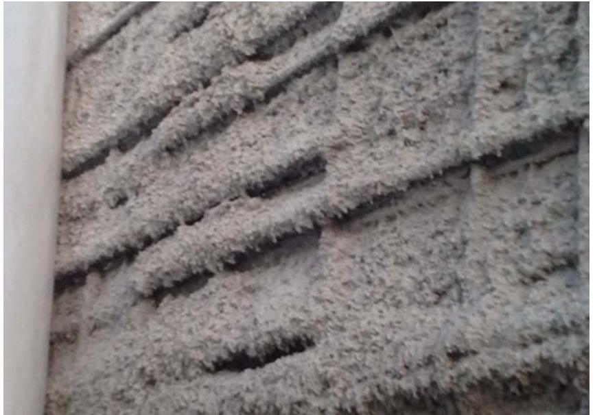
Fig. 5: La evidencia visual de la acumulación de concreto en el refuerzo fue ignorada por el lanzador. Nótese los enormes vacíos que se han formado detrás del acero.
